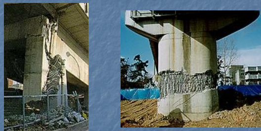
地震被害/兵庫県南部地震(1995)におけるRC橋脚の地震被害
